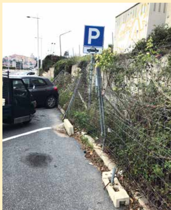
Lungomare Marinai d'Italia, marciapiede disastroso
